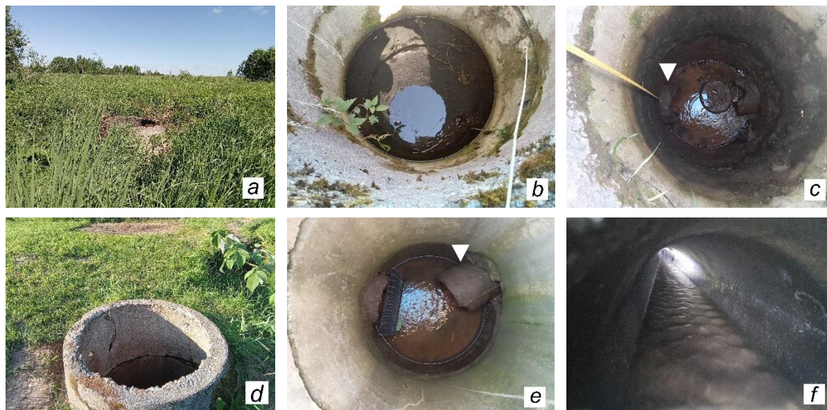
a – общий вид смотрового колодца СК-8; b – смотровой колодец СК-8 (уровень воды выше верха трубы коллектора), 04.06.2025; c – смотровой колодец СК-8 (сразу после сброса воды), 23.07.2025; d – общий вид смотрового колодца СК-9; e – трубопровод коллектора в СК-9; f – трубопровод коллектора в СК-9 (полость трубы) a – general view of inspection well SK-8; b – inspection well SK-8 (water level above the top of the collector pipe), 04.06.2025; c – inspection well SK-8 (immediately after water discharge), 23.07.2025; d – general view of inspection well SK-9; e – collector pipeline in SK-9; f – collector pipeline in SK-9 (pipe cavity)
