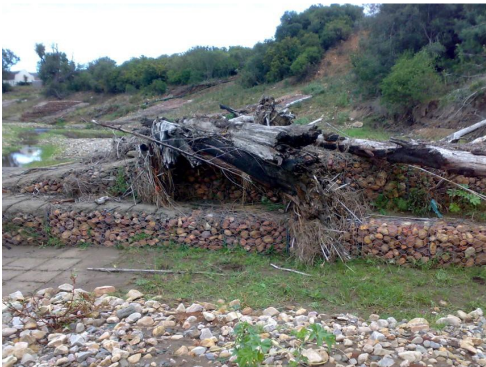
Рисунок 6 – Повреждение деревьями шпора [6]
