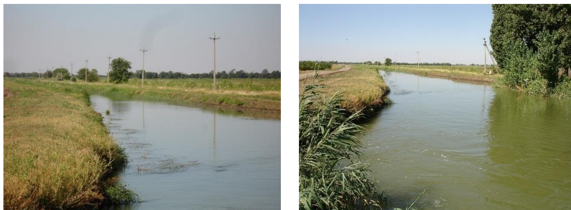
Рисунок 1 – Состояние оросительных каналов в ОАО «Нива» Весёловского района (фото автора)
